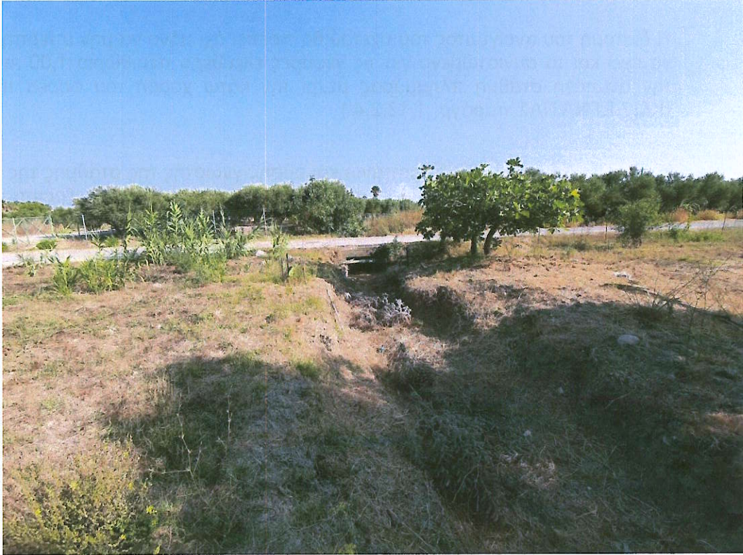
Εικόνα 0.4 : Αποψη ανάντη τμήματος κοίτης και οχετός ασφαλτοστρωμένης οδού. Διακρίνεται το πολύ μικρό μέγεθός του και τεκμαίρεται και μόνον από την εικόνα η ανεπάρκειά του
