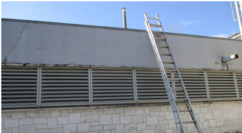
Εικόνα 12: Λεπτομέρεια στη βόρεια πλευρά – Διακρίνεται η ρηγμάτωση ανεστραμμένης δοκού του δώματος.
