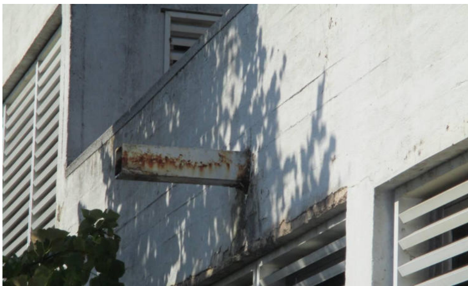
Εικόνα 5: Λεπτομέρεια στην ανατολική πλευρά – Διακρίνεται η προέχουσα υδρορροή και η διάβρωση της δοκού σκυροδέματος.
