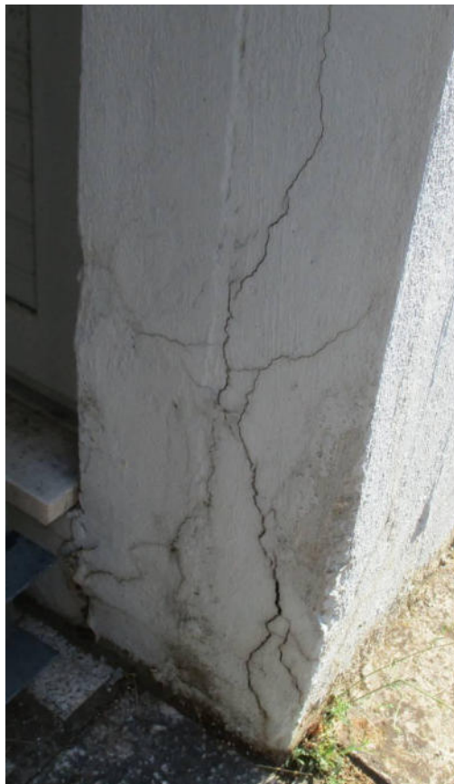
Εικόνα 11: Λεπτομέρεια στη βάση υποστρώματος στη νότια πλευρά – Διακρίνεται η ρηγμάτωση λόγω ενανθράκωσης σκυροδέματος.
