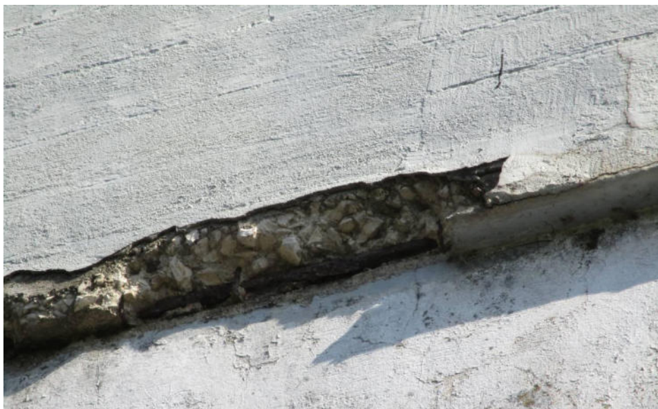
Εικόνα 7: Λεπτομέρεια διάβρωσης σκυροδέματος και οπλισμού.
