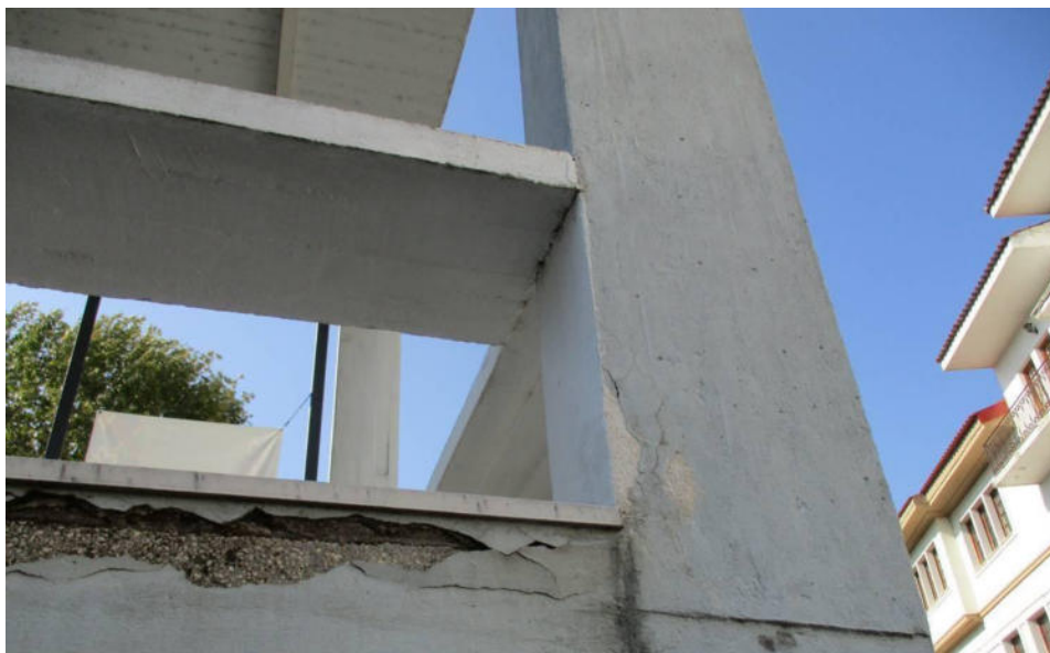
Εικόνα 9: Λεπτομέρεια της δυτικής εισόδου – Διακρίνεται η αποφλοίωση σκυροδέματος και νεώτερη επισκενή στο υποστύλωμα.
