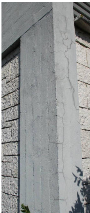
Εικόνα 10: Λεπτομέρεια στη ΝΑ γωνία του κτιρίου – Διακρίνεται η ρηγμάτωση του υποστρώματος στις θέσεις του οπλισμού.
