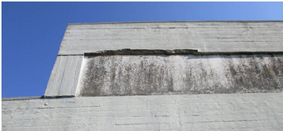
Εικόνα 6: Λεπτομέρεια στη βόρεια πλευρά – Διακρίνεται η αποτίναξη επικάλυψης και η εμφάνιση του οπλισμού στη βάση της περιμετρικής δοκού του δώματος.
