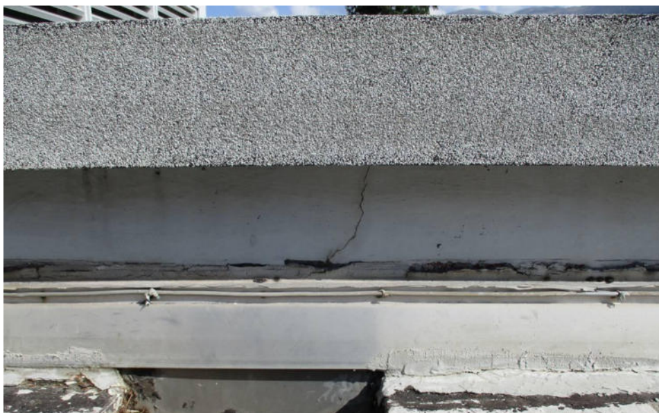
Εικόνα 13: Λεπτομέρεια στη στεγάνωση του δώματος σε θέση υδρορροής – Διακρίνεται η εσωτερική πλευρά της ρηγμάτωσης της ανεστραμμένης δοκού.
