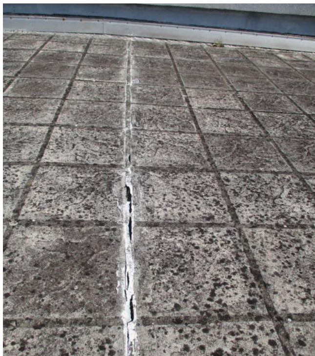
Εικόνα 15: Λεπτομέρεια του δώματος – Διακρίνεται η φθορά της υγραμόνωσης στον αρμό.
