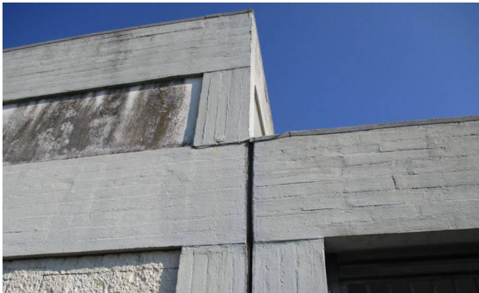
Εικόνα 8: Λεπτομέρεια στη βόρεια πλευρά – Διακρίνεται ο αρμός διαστολής και η εμφάνιση υγρασίας στην επιχρισμένη οπτοπλινθοδομή.
