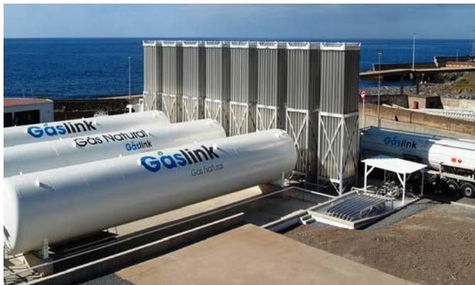
Small Scale LNG Vaporization
