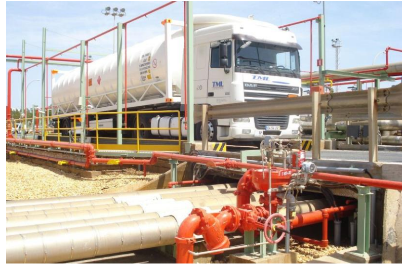
LNG Truck Loading
